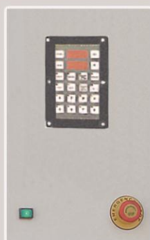
Painel de Controle Numérico
