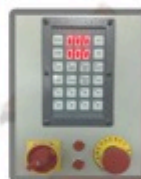
Pannello di controllo 24V
