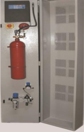
Üst düzey güvenli Dahili yangın söndürme sistemi
